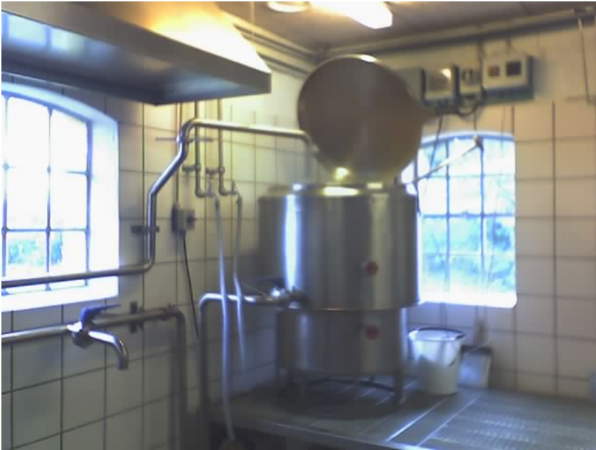
Figur 1 Hovedinstallationen – det store mæskekar.
